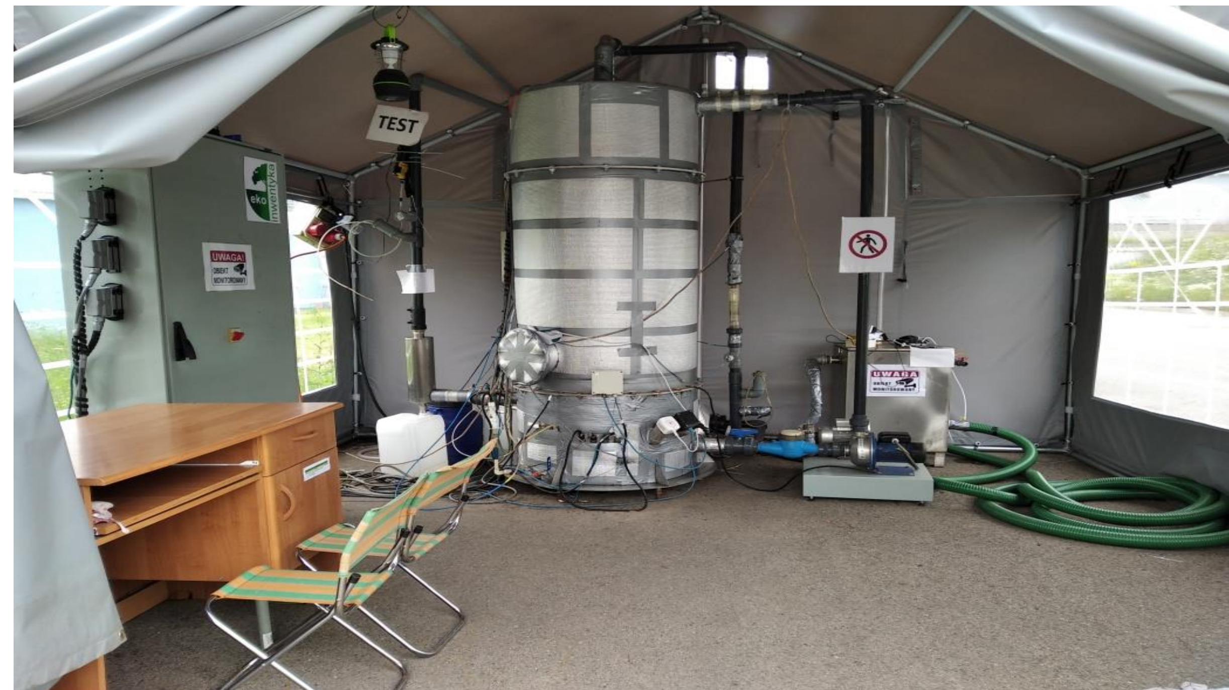
Rys. 5. Instalacja KBT do biooczyszczania powietrza z odorów, skala pilotażowa
